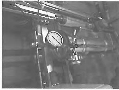
Vanne de purge
